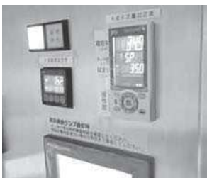
制御盤パネル面
