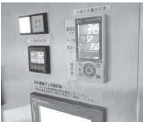
制御盤パネル面
